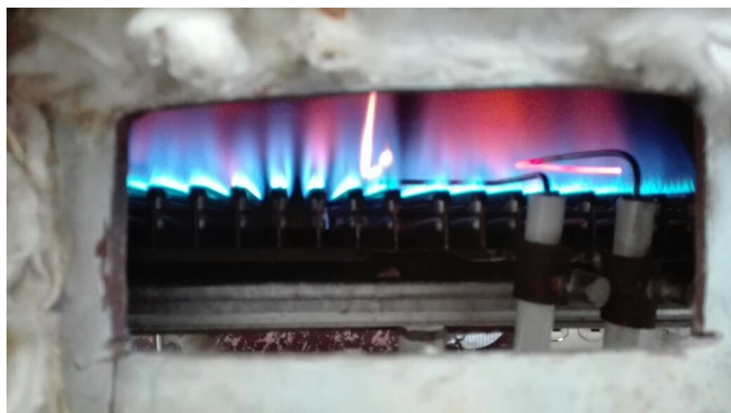
Fig 7 Foto colocación varilla de ionización PA 4001
